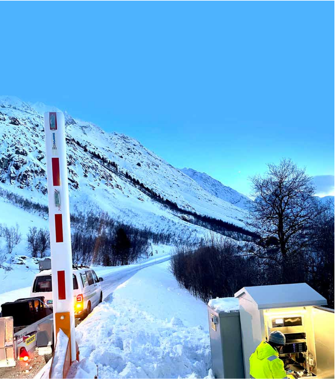
Installasjonen i Holmbuktura i Troms. Foto: Peder Anker, Norconsult
